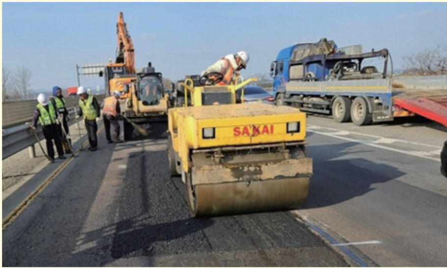
10개 구간 7.9km에 20억 원을 들여 지난 3월 신속하게 보수를 완료했다. 전남도는 보수가 끝난 이후에도 도로
